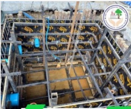
รับแก้ปัญหาระบบบำบัดน้ำเสีย บริษัท เซฟเอ็นไวรอนเมนทอล คอนซัลแตนท์ จำกัด
